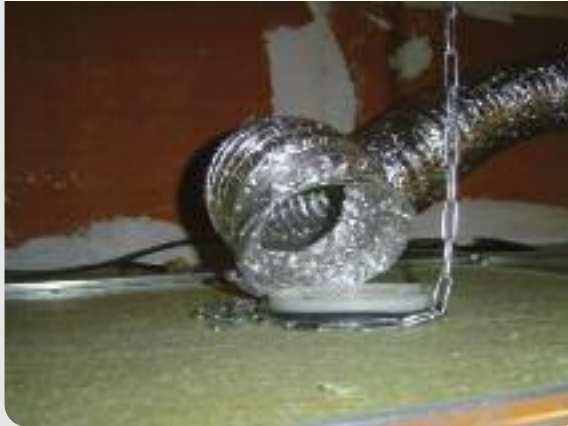
Photo 12 : Bouche déconnectée au-dessus du plafond
