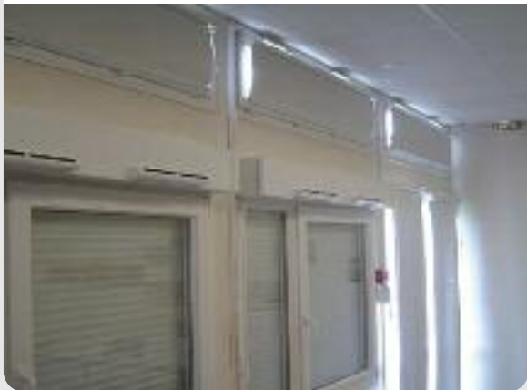
Photo 9 : Entrées d'air dans un dortoir
