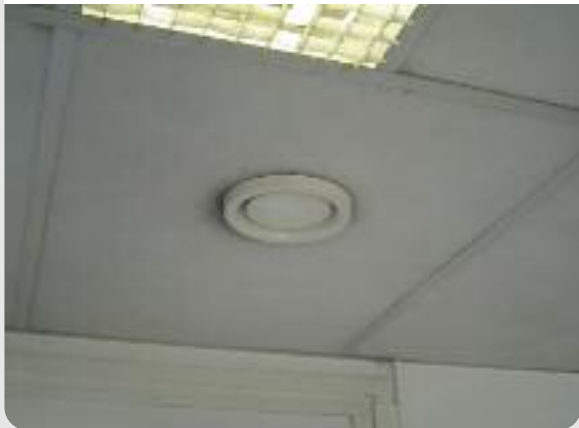
Photo 10 : Bouche de soufflage d'air dans une cantine
