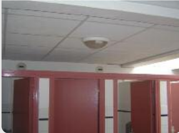
Photo 11 : Bouches d'extraction dans des sanitaires
