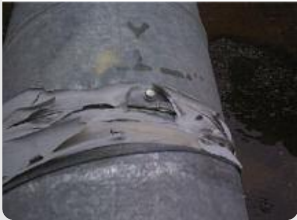
Photo 6 : Adhésifs détériorés sur conduits extérieurs
