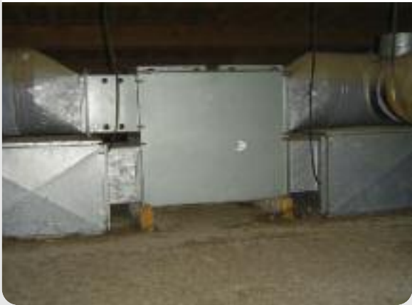
Photo 1 : Centrale double flux dans des combles
