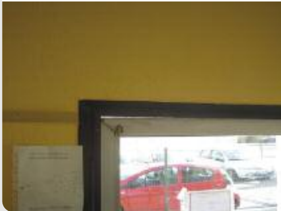
Photo 14 : Porte-fenêtre non étanche à l'air (jour visible)
