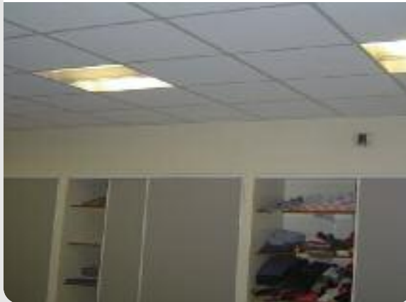
Photo 13 : Bouches d'extraction d'air dans un dortoir
