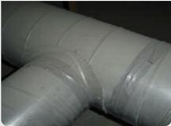
Photo 5 : Conduits étanches en combles
