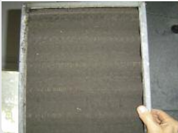
Photo 15 : Filtre de CTA très encrassé
